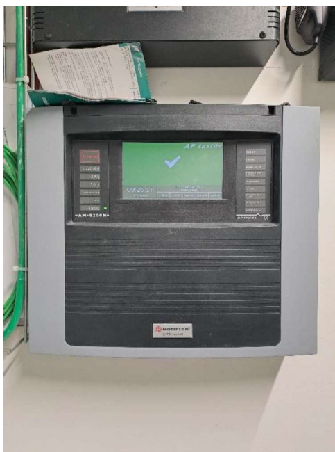
Centrale rivelazione e allarme incendio in locale tecnico al piano terra
