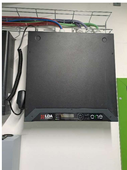
Centrale EVAC in locale tecnico al piano terra
