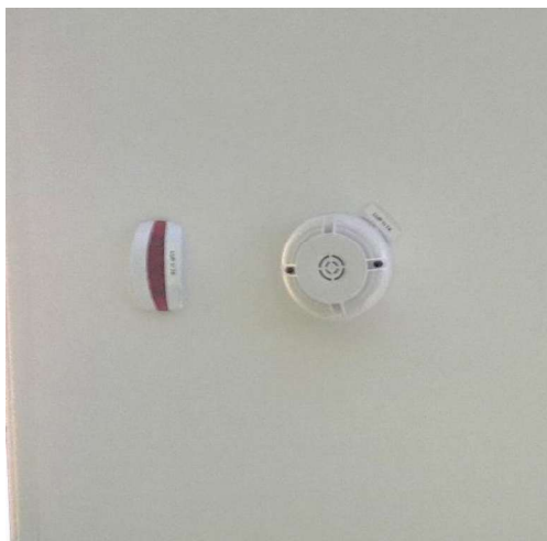
Rivelatore puntiforme di fumo in ambiente e spia luminosa rivelatore in controsoffitto
