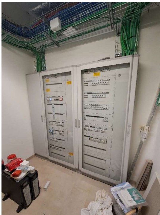
Quadro elettrico generale, quadro elettrico piano terra e UPS piano terra in locale tecnico al piano terra
