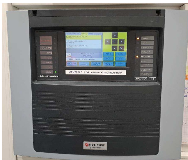
Centrale rivelazione e allarme incendio
