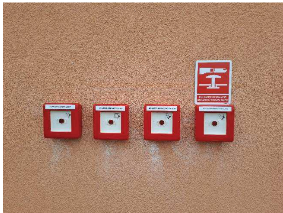
Foto 1 – interruttori di emergenza impianti elettrici
