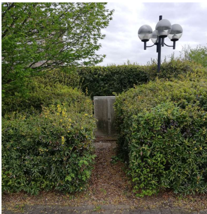
FOTO 4 Il quadro elettrico esterno installato in posizione baricentrica rispetto ai parcheggi 1 e 2 al quale afferiscono le varie linee di alimentazione delle zone dei parcheggi
