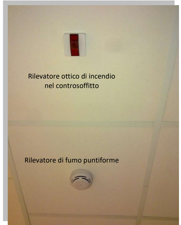
Rilevatore ottico di incendio lungo il corridoio, riferito a locale chiuso
